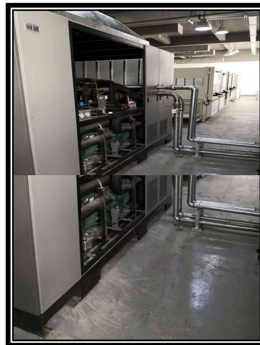
冷冻机组（位于箱体后部）
